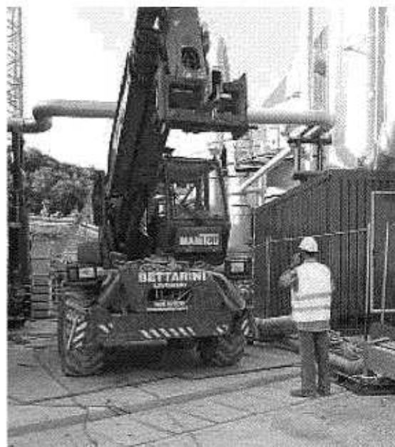
PROGETTI Alla centrale geotermica di Bagnore 4 si prosegue con il monitoraggio degli esperti
